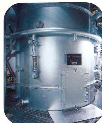
高温ガス化直接溶融炉
