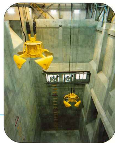
ごみクレーン
