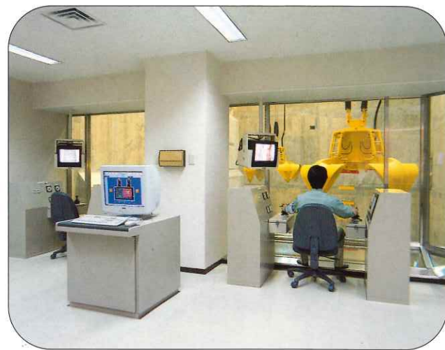
ごみクレーン操作盤
