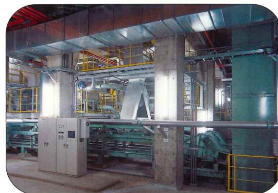
水砕物搬送コンベア
