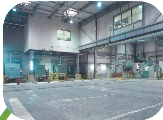
リサイクルプラザ プラットホーム
