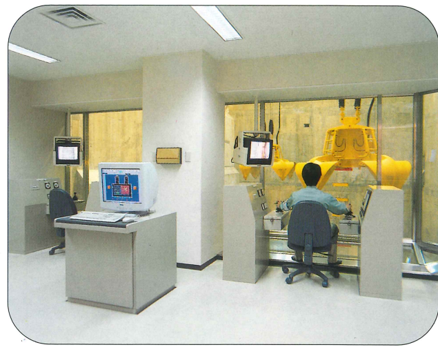
ごみクレーン操作盤
