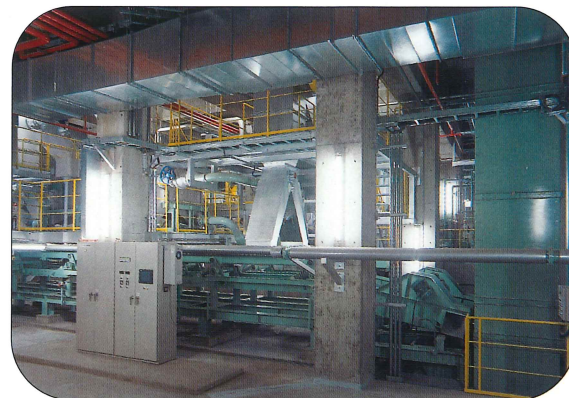
水砕物搬送コンベア
