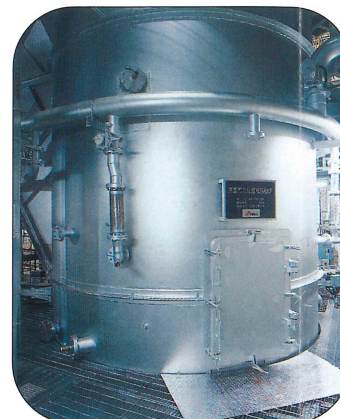
高温ガス化直接溶融炉
