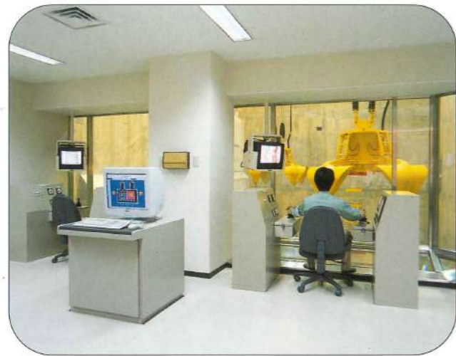
ごみクレーン操作盤
