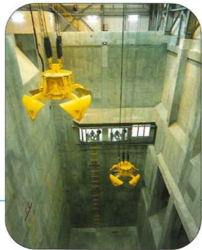
ごみクレーン
