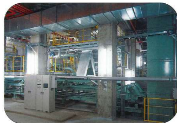
水砕物搬送コンベア
